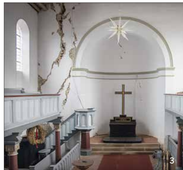
Abb. 3 Druxberge, Dorfkirche, Bauschäden durch klimawandelbedingte Veränderung des Baugrundes, Zustand vor Instandsetzung
